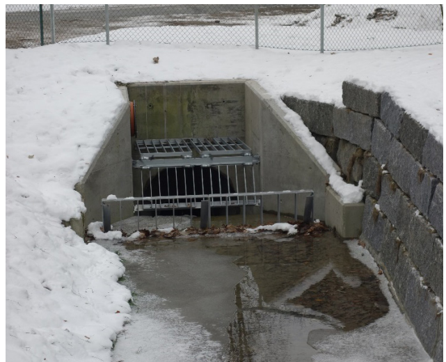
Figur 9.20 Selvrensende innløpsarrangement i Solbergbekken, Bærum kommune. (Foto: Yvona Holbein, Oslo kommune)
