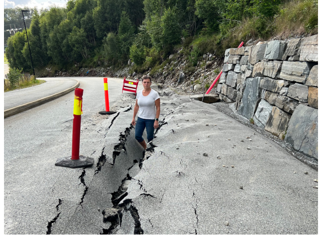
Veien trengte vedlikehold og kommunen reagerte ikke på gjentatte varsler om behov for reparasjon. Sommeren 2023 kom et kraftig regn som ødela veien fullstendig. Sandnes kommune. (Foto: Inger Anita Merkesdal, Vannfakta.no)
