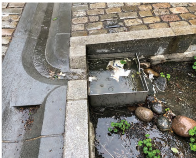
Sedimentasjonskammer for oppsamling av sand og avfall ved innløpet til Deichmans gate. (Foto: Gatenormalen i Oslo)
